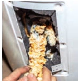
Teure Energiebremse: Kalk auf Heizstäben erhöht den Stromverbrauch massiv.
